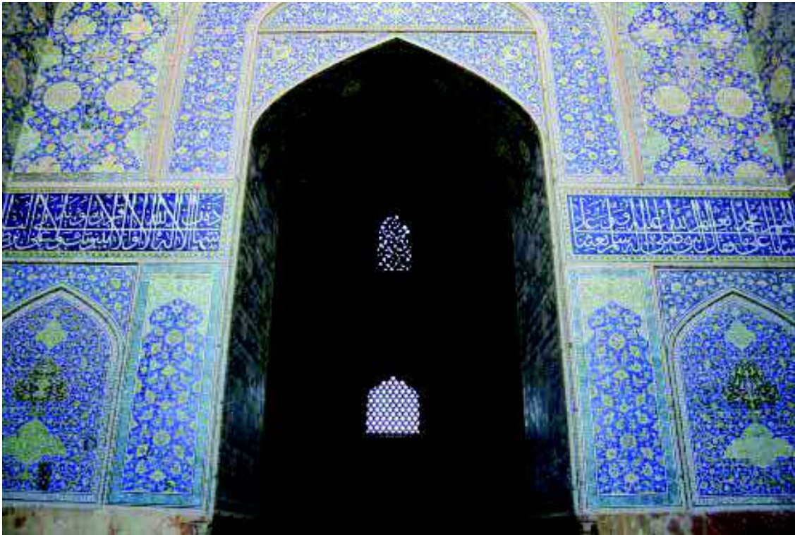
Figure 91 - Revêtement en céramique
