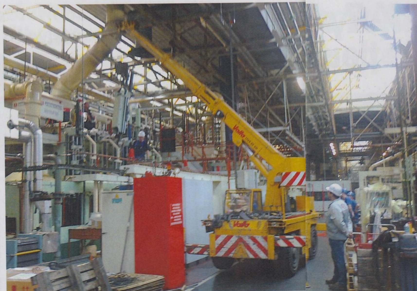
▲ Bâtiment 7 - OP 170 6 semaines de travaux ont été nécessaires aux carters TUF pour la rénovation complète de 4 broches ainsi que de la commande numérique FANUC.
