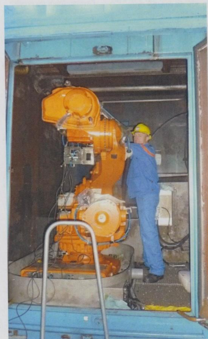
▲ Aux bâtiments 3 et 8, opération de vérification des câbles des robots ABB.
