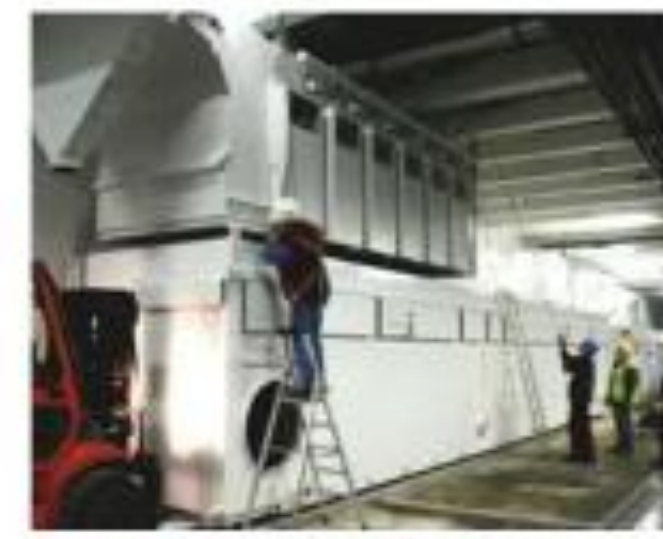
2012 : Installation de la galerie technique La galerie technique est démarrée et exploitée par les équipes d'UTM.
