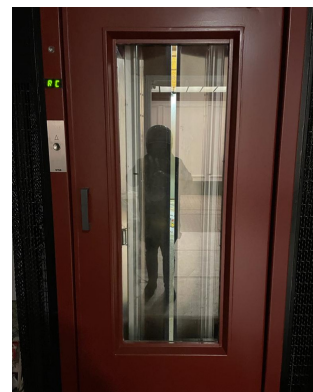
Take the elevator/Prenez l'ascenseur
