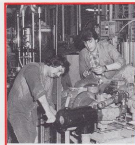
L'Atelier de Montage X est désert. A. Tkacz et M. Parquet de l'équipe de nuit du "Préventif" installent un nouveau groupe hydraulique sur la "MS-blocs".
