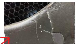
Figure 22: défaut de fabrication corrigé
